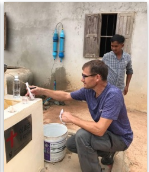
Lukas testet das Wasser vor Ort, nachdem die Filter ausgewechselt wurden.
